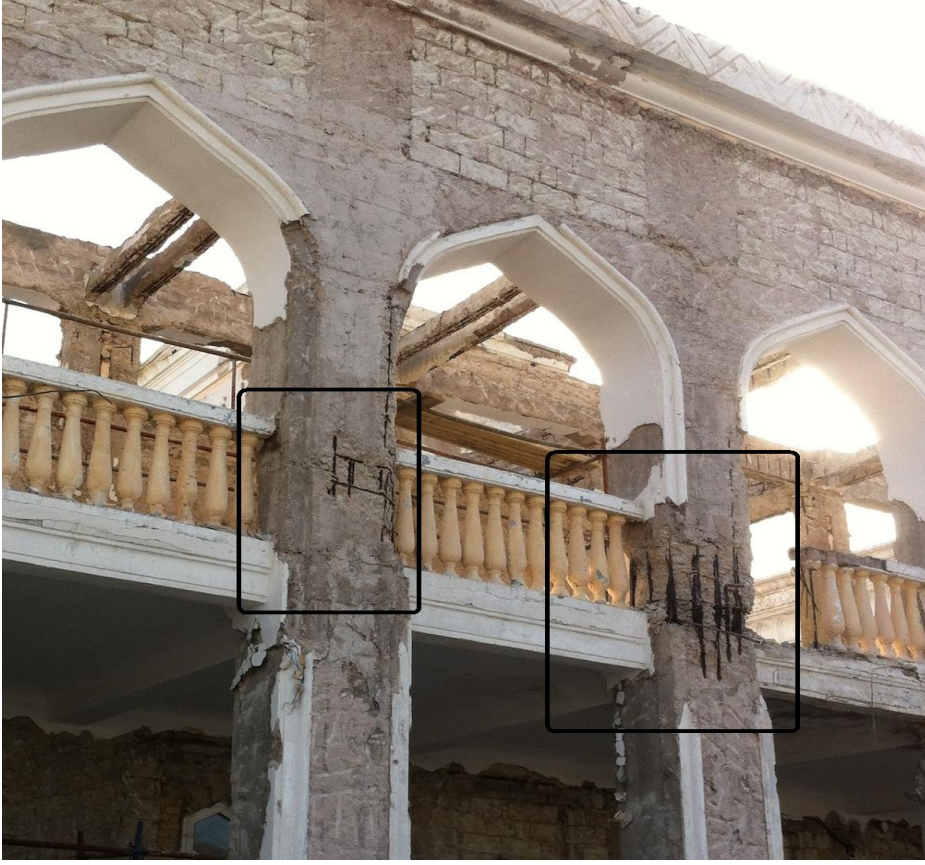
Kolon kiriş birleşim bölgesi hemen hemen mafsallaşmak üzere.
