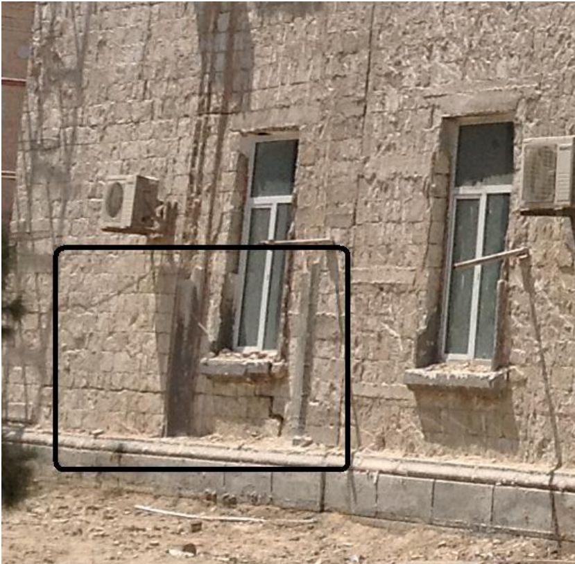
Yine arka binada oluşmuş ayrışma hasarına örnek.
