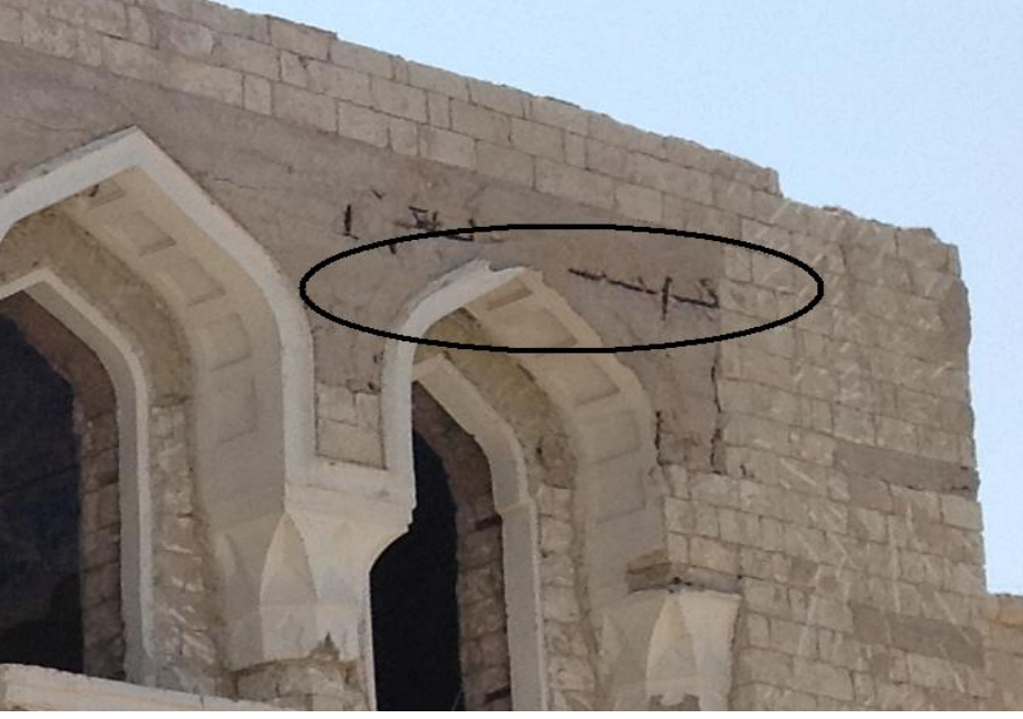
Ayrık binalarda korozyona bağlı hasar örneği
