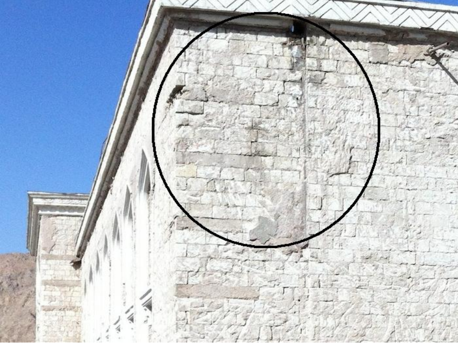
Üst köşede oluşmuş diyagonal deprem çatlağı
