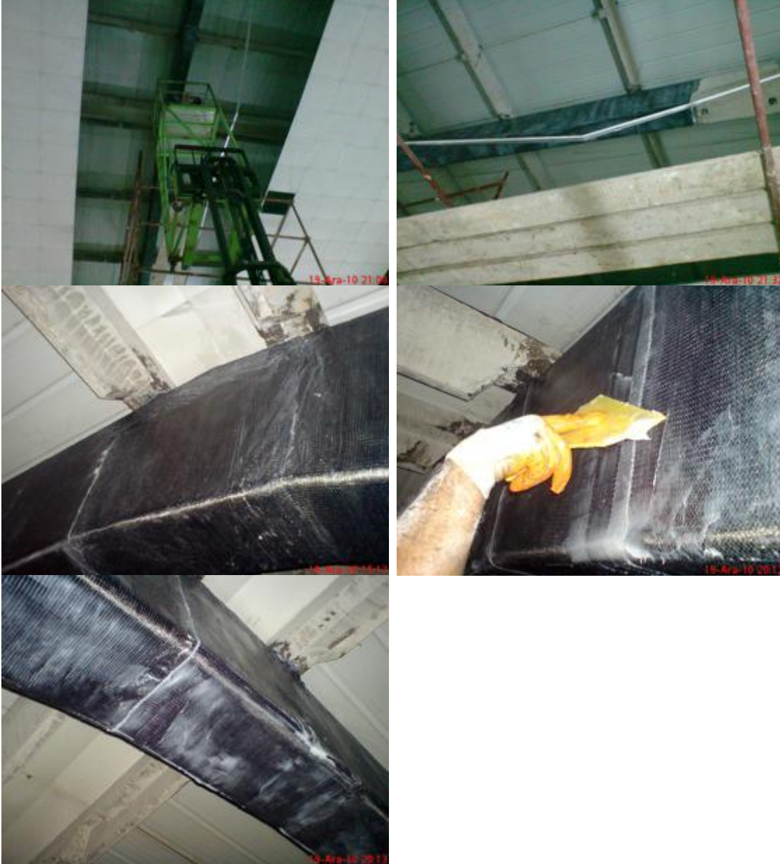
Şekil 8. Kirişlerde yapılan LP uygulamasından örnek resimler
